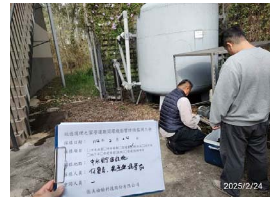
(中水貯留設施)
